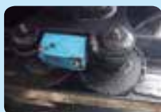
近接スイッチの破損
